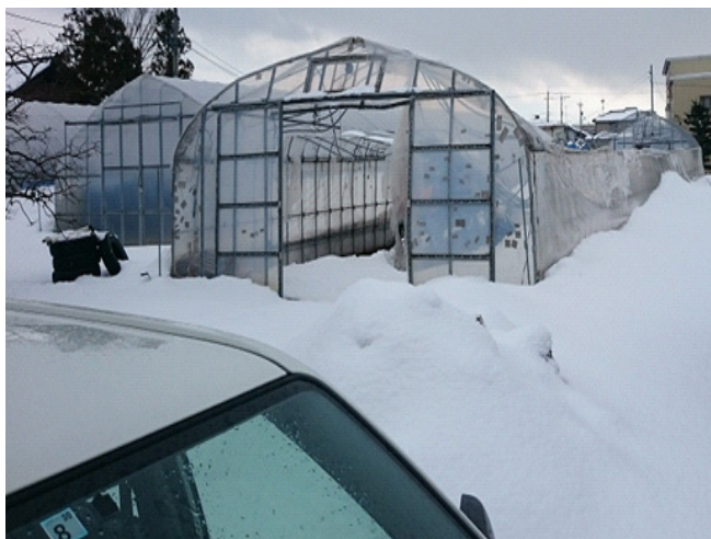
倒壊したビニールハウス
